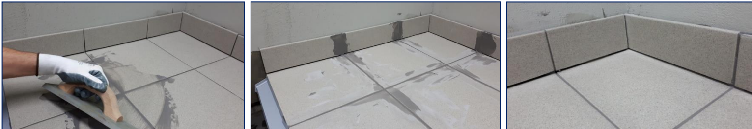
naniesť škárovaciu hmotu na plochu a sokel. stykové škáry, rohy a kúty sa neškárújú
